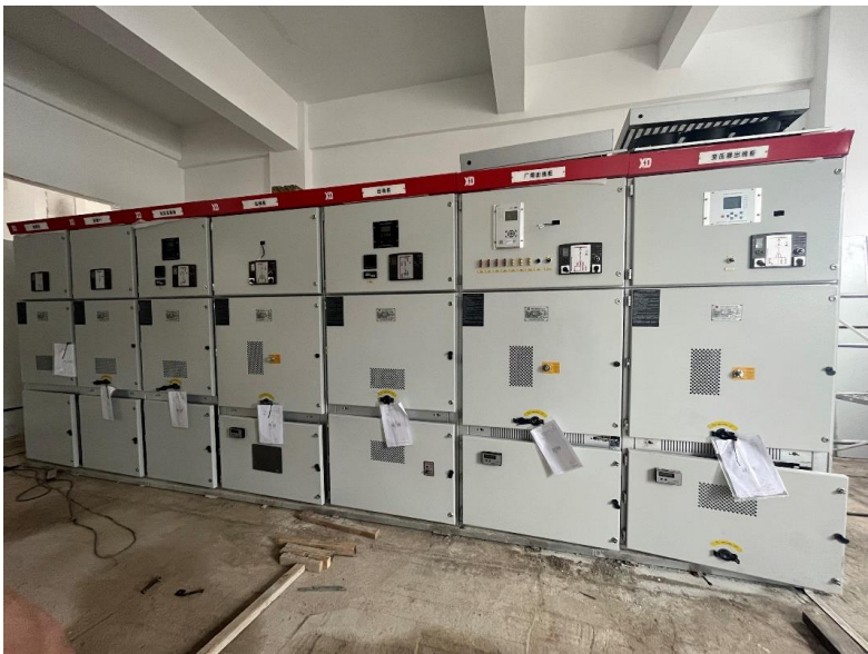
图 1.2 户内金属铠装可移动式开关柜
